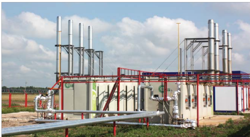
Рис. 3. Микротурбинные установки Capstone в ЗАО «Татех»
