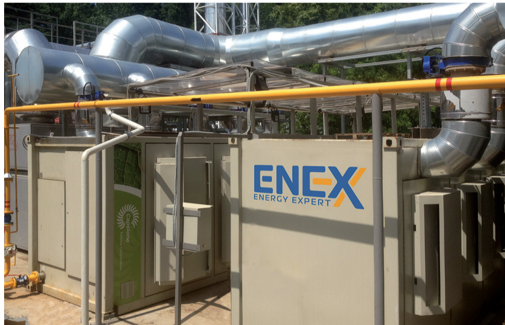
Микротурбинный энергоцентр санатория «Мыс Видный», г. Сочи
